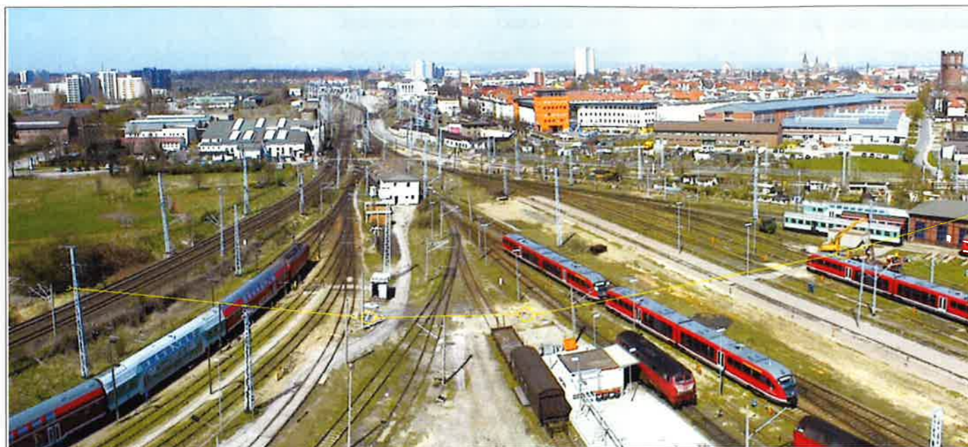
Unbehelligt verlief der Rostocker Schienenverkehr - während die Spezialisten der Firma Wähler ein riesiges Freigefällerohr sanierten.
