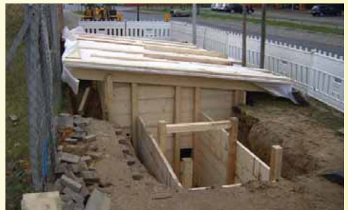
110KV Muffengrube mit Einhausung
